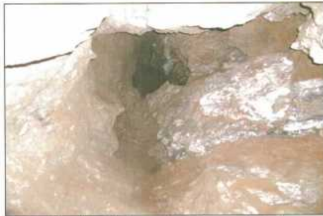
Fig. 14 - Vidange karstique au toit d'une carrière de gypse (commune de champ/Drac)
